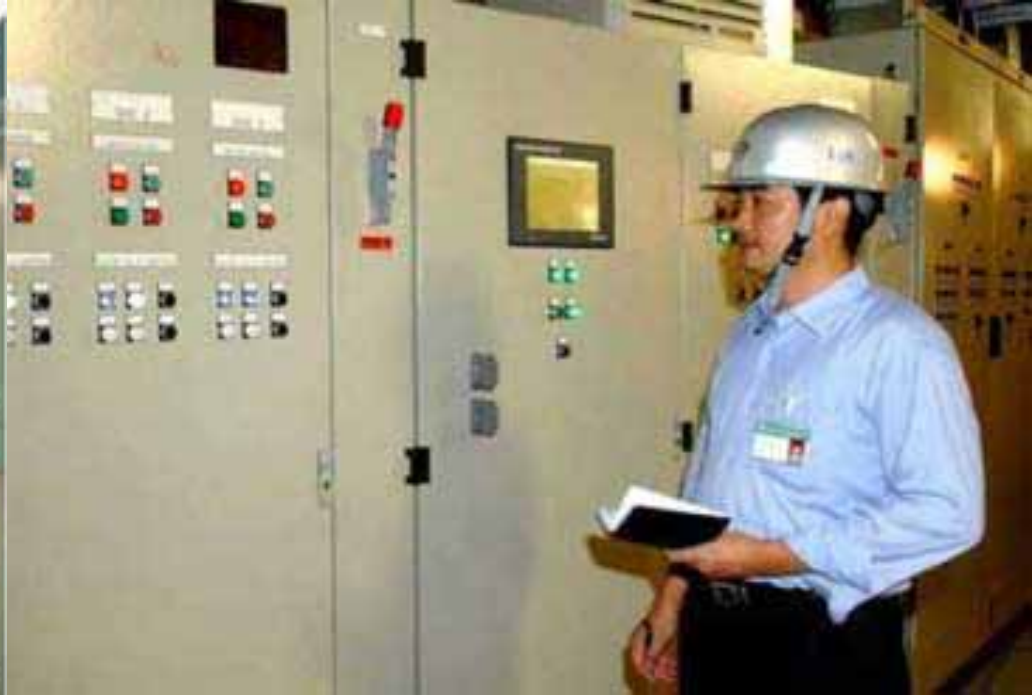
三峡左岸电厂中控室
